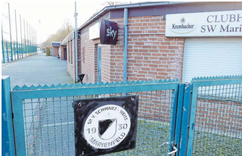
Betrag: Das Clubheim und die Umkleiden des SV SW Marienfeld haben schon bessere Tage gesehen. Kostspielige Reparaturen sind notwendig. Als Alternative schlägt der Verein einen kompletten Neubau vor.
